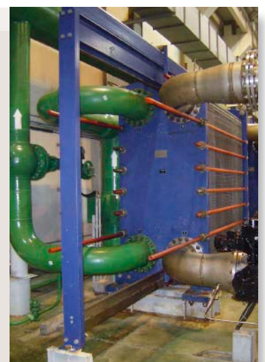
田湾核电一共使用了46台阿法拉伐带垫圈的板式换热器。
