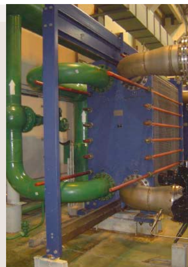
La centrale de Tianwan utilise 46 échangeurs thermiques à plaques Alfa Laval.
