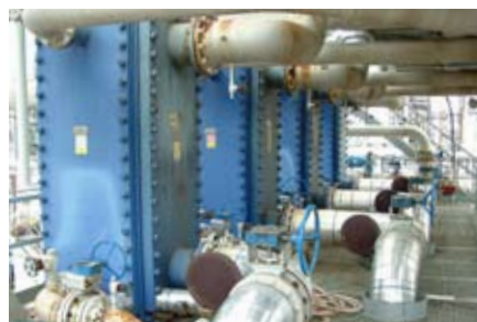
Compabloc Plattenwärmeübertrager von Alfa Laval im Einsatz in der Sarnia-Raffinerie.
