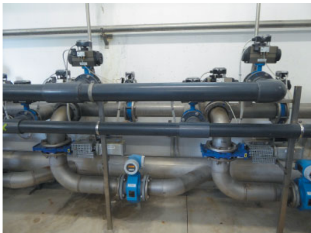
Рис. 6. Трубопроводы выгрузки пермеата и химической промывки
