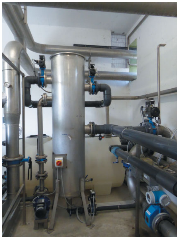
Рис. 8. СИСТЕМА БЕЗРАЗБОРНОЙ СІР-МОЙКИ. НА ПЕРВОМ ПЛАНЕ – БАК ДЛЯ СОЗДАНИЯ ГИДРОСТАТИЧЕСКОГО ДАВЛЕНИЯ, НА ЗАДНЕМ – БАК ДЛЯ РАСТВОРА РЕАГЕНТА
