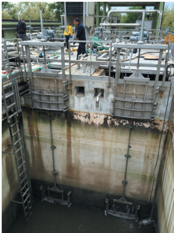
Рис. 4. Шиберы между биореактором и мембранным отделением (фото сделано при запуске ОС, на котором окна закрыты шиберами)
