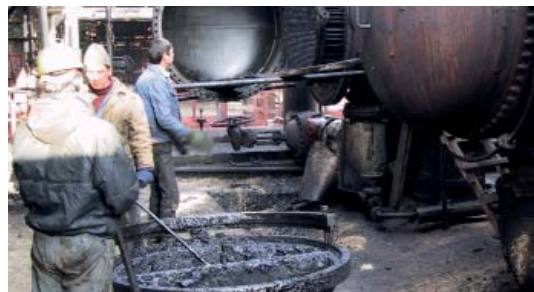
Кожухотрубный теплообменник (КТТО) после 3-х лет работы в технологическом процессе, сопровождающимся образованием отложений
