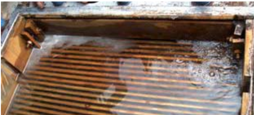
Фотография течи в месте угловой сварки теплообменника Comtrabloc, выявленная воздушно-пузырьковым методом.
