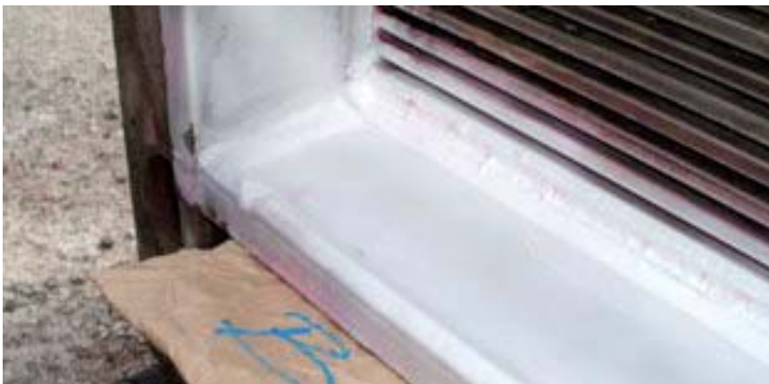
Результат тестирования методом проникающего красителя после проведения ремонта угловой течи с помощью аргонно-дуговой сварки.
