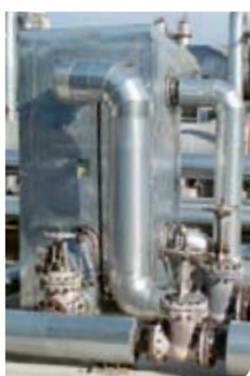
Теплообменники Comaploc на Туапсинском нефтеперерабатывающем заводе компании «Роснефть»
