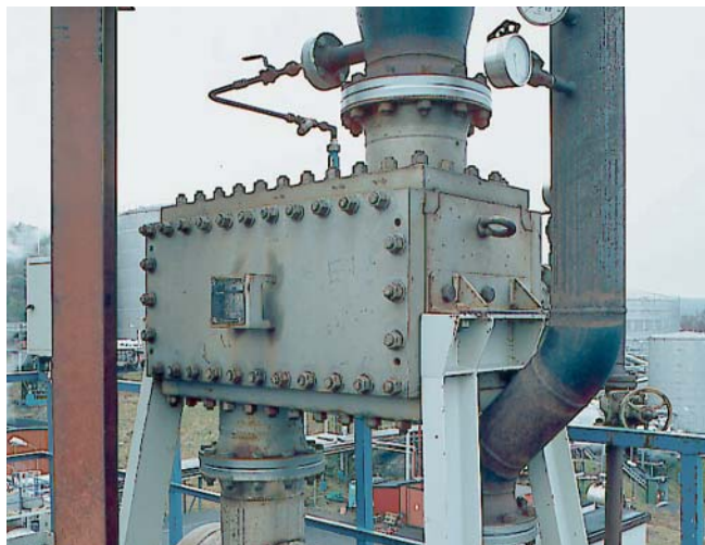
Comrabloc горизонтального монтажа из титана (конденсация пара в вакуумной дистилляционной колонне).
