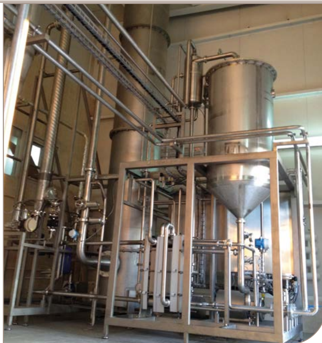
Дегазатор и отпарная колонна модуля деалкоголизации Альфа Лаваль
