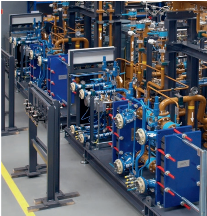
Пластинчатые теплообменники Альфа Лаваль, установленные в системе охлаждения турбин электростанции Medupi
