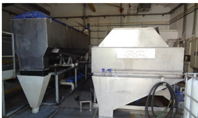
Istniejący obrotowy zagęszczacz bębnowy Alfa Laval (po lewej) oraz nowy zagęszczacz taśmowy AS-H Alfa Laval.
