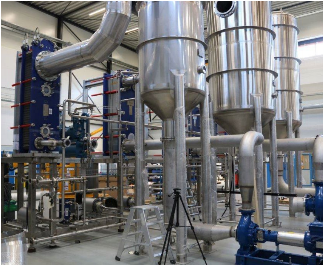
3E-AlfaFlash während Montage 7t/h Eindampfleistung
