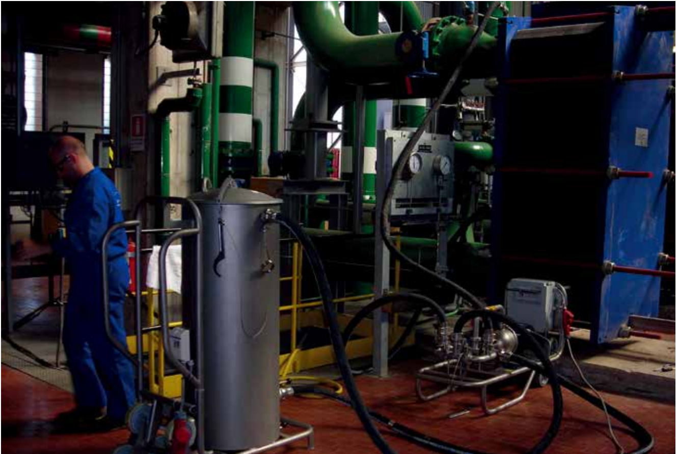
某客户工厂内安装的 M30 换热器
