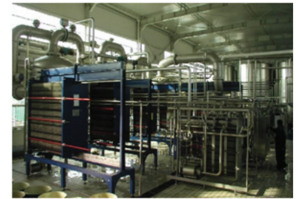
Figura 4: Evaporador de maçã, 45 toneladas por hora de água evaporada, com pasteurizador e recuperador de aroma.
